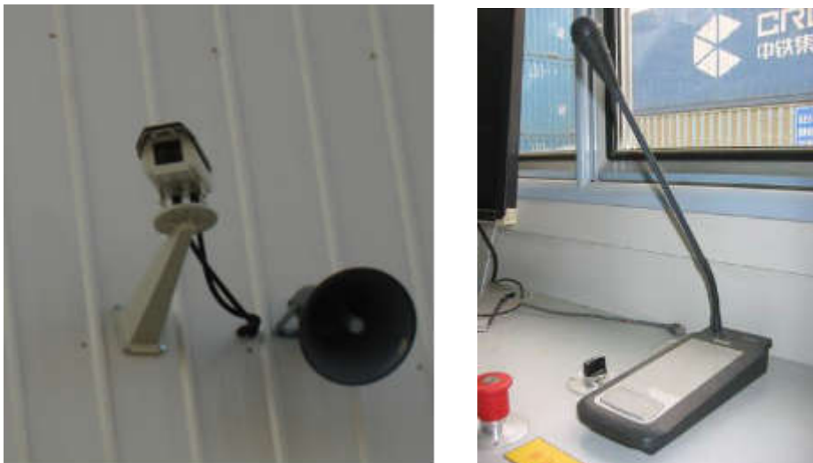
图 10-9 同型号检测系统监视和通讯设备
