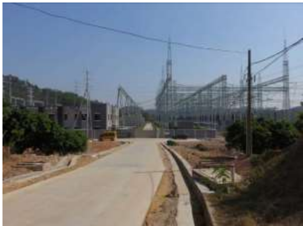
500kV 纵江变电站
